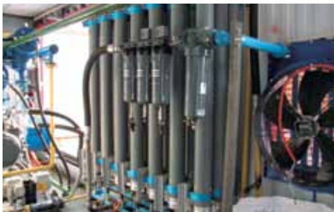
Мембранный газоразделительный блок
